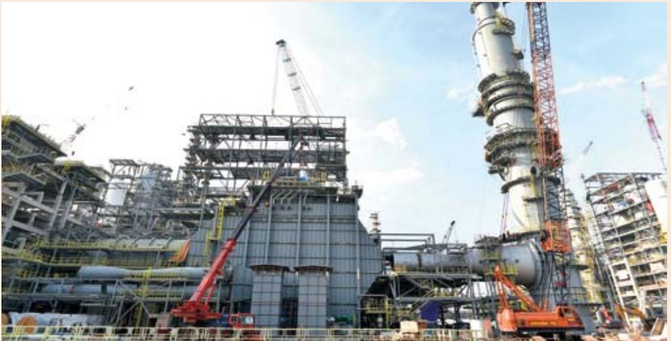
Pembangunan Bersepadu Penapisan Minyak dan Petrokimia (RAPID) PETRONAS di Pengerang.
